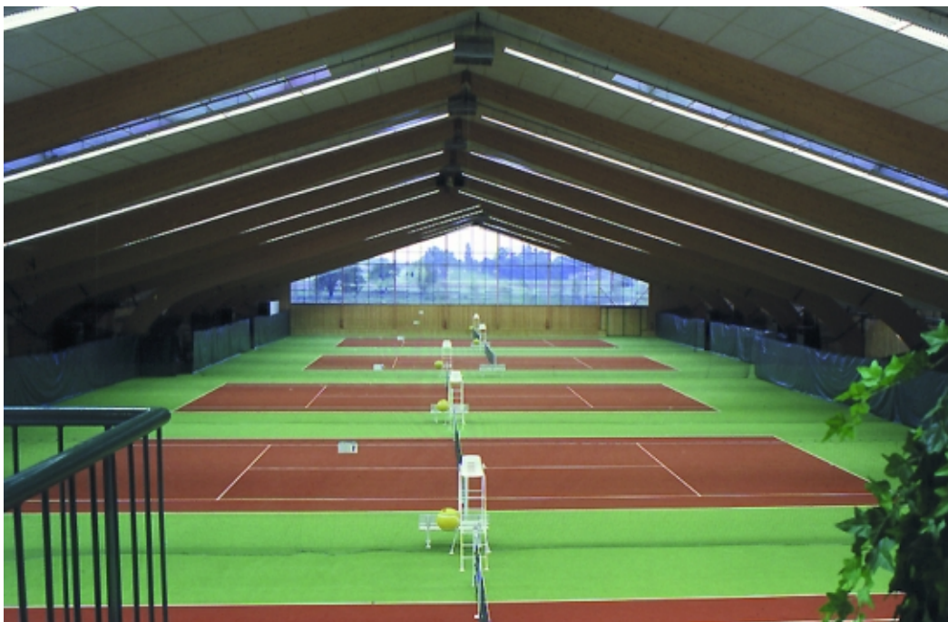
Les tubes fluorescents sont généralement installés parallèlement aux couloirs de double.
